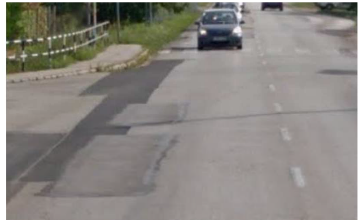
Az úthelyreállítás hibái, eltérő színű burkolatok
